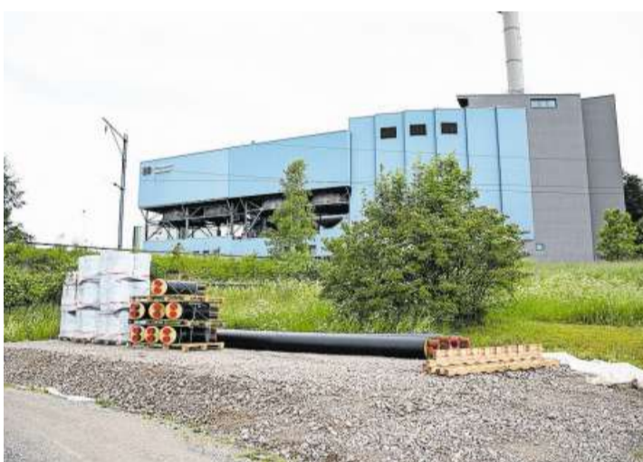
Die Fernwärmerohre sind bereit für die Verlegung ab der ZAB in Bazenhaid (im Hintergrund).
